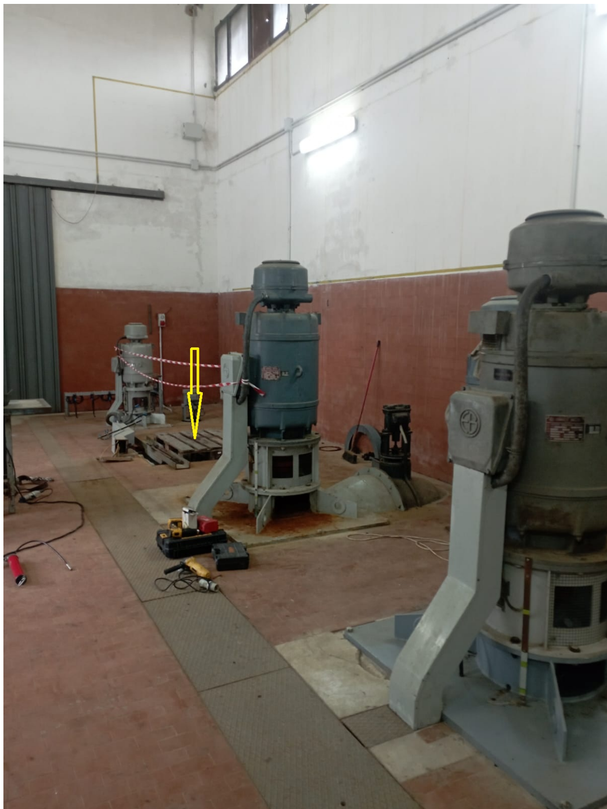
Foto 3) Punto di installazione gruppo pompa
