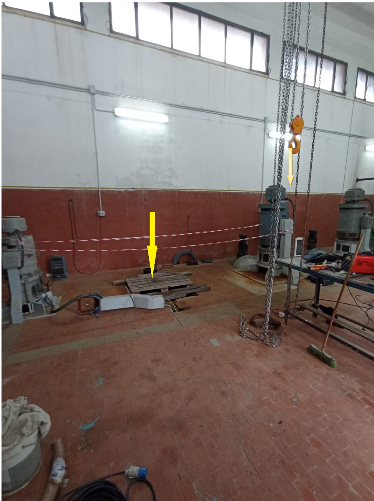
Foto 2) Punto di installazione gruppo pompa
