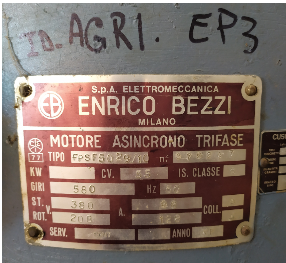
Foto 5) targhetta motore elettrico
